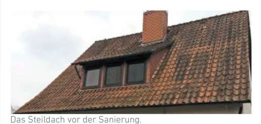
Das Steildach vor der Sanierung.
